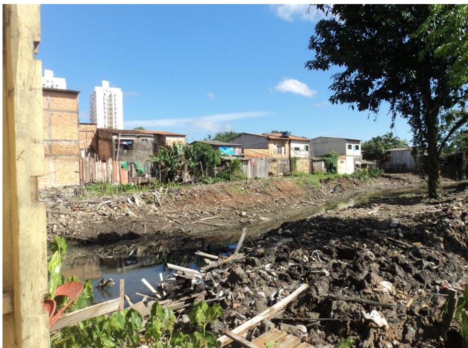
Fotografia 19 - Comunidade Cubatão com várias palafitas derrubadas
